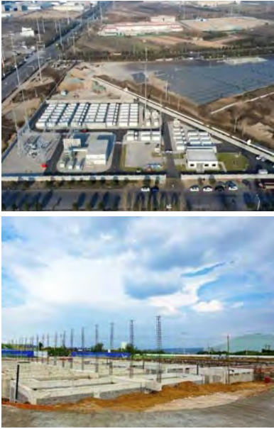
三门峡发电公司在建的三门峡示范区独立共享储能电站项目，一期容量为 100 兆瓦 /200 兆瓦时
